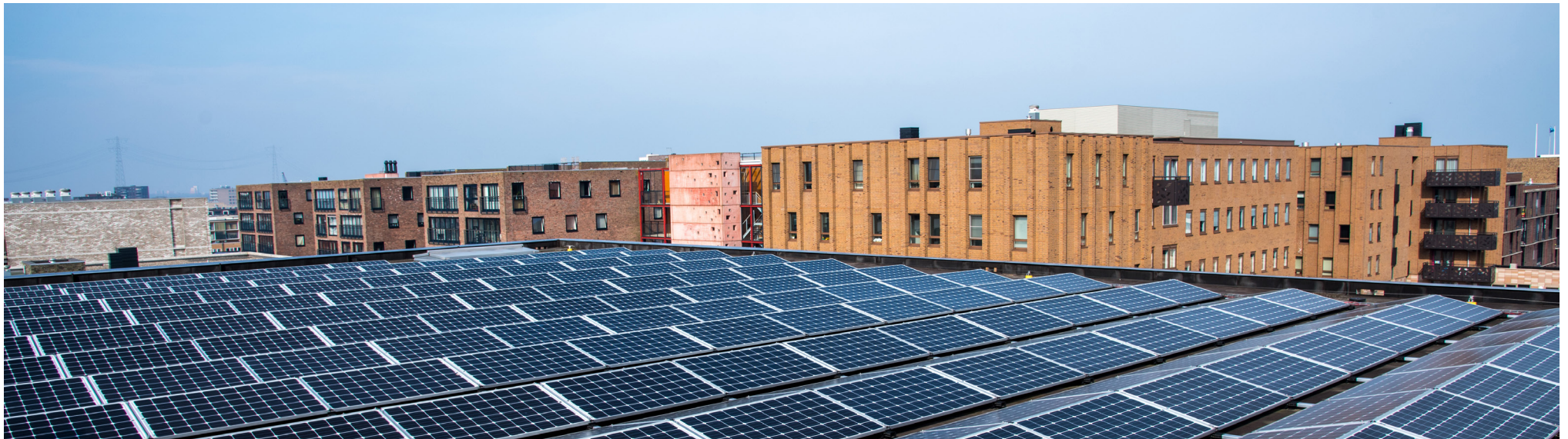
Afb. 8.5 Zonnecollectoren op het dak van het IJburg College, Amsterdam Oost
